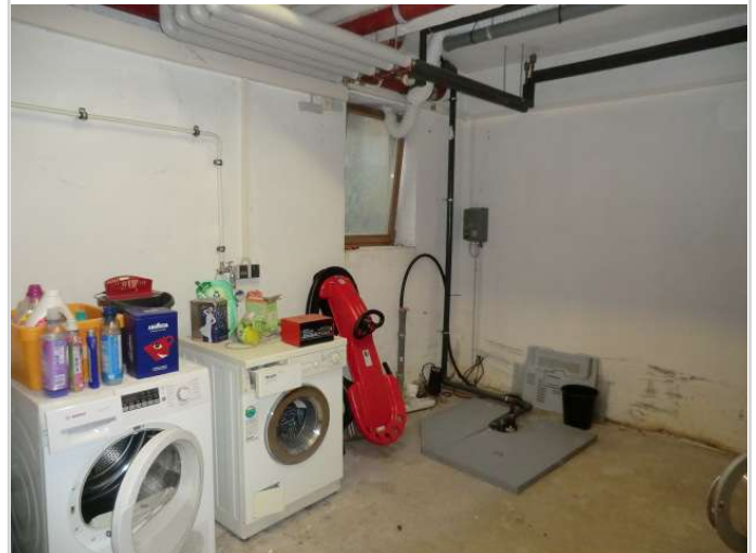
Waschküche mit Anschlüssen
